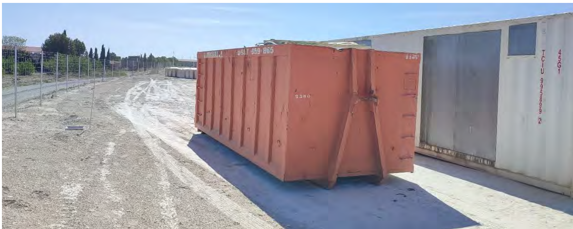
Ilustración 8. Contenedor para la clasificación de los residuos generados en la obra.
